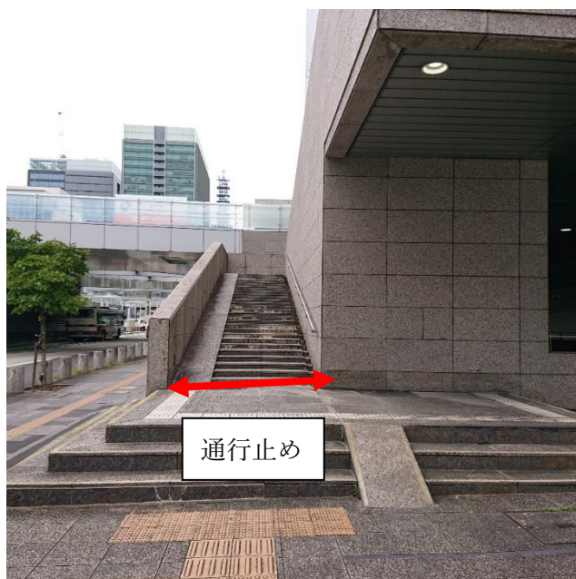
③ 建物西側階段は通行止めです。
