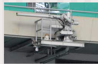
大型施設では火災対策も重要。場内には赤外線火災検出器4基と放水銃4台が設置されている。なお、緊急車両の動線なども常に意識されているとのこと。
